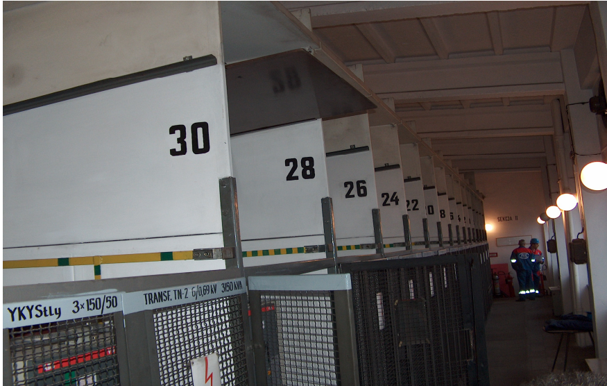
Rys. 2 Rozdzielnia główna SN badanego zakładu przemysłowego
