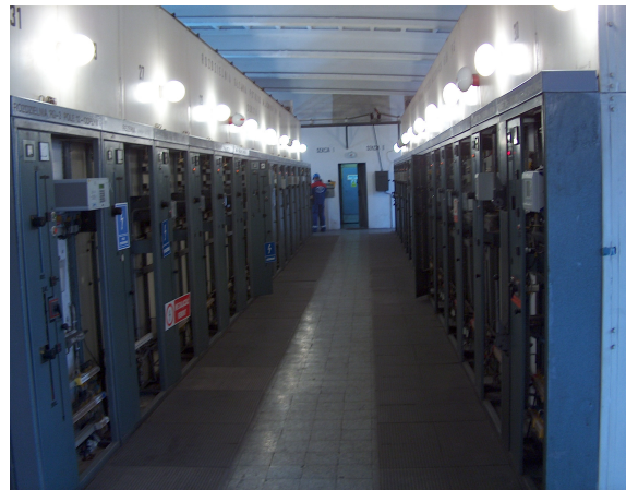
Rys.2. Rozdzielnia główna SN badanego zakładu przemysłowego
